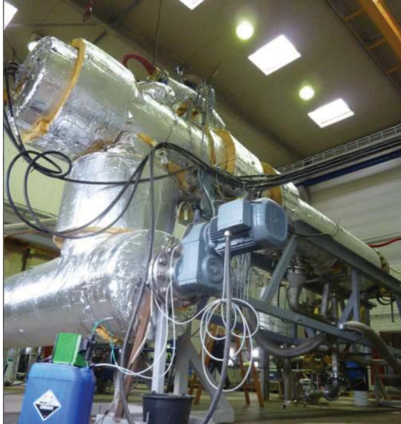
图 23: BioGasol- Carbofrac™100 预处理技术示范装置 (1 吨/小时)
